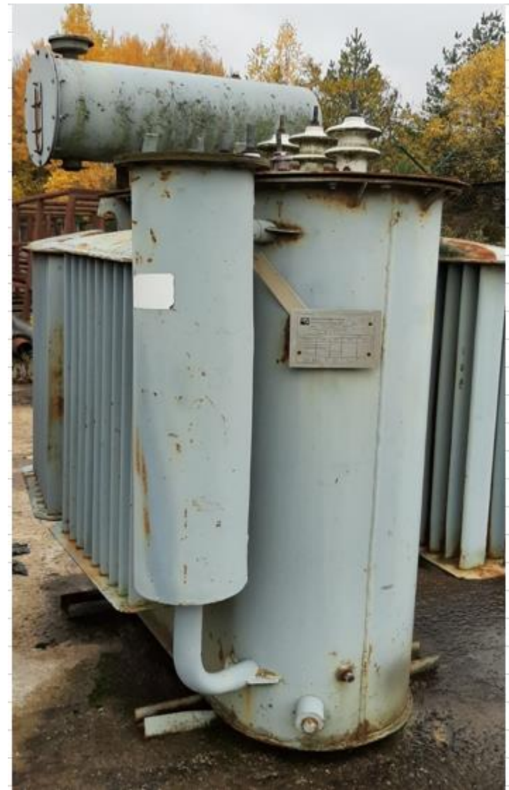
ТМ-400/10 tipo transformatorius.
