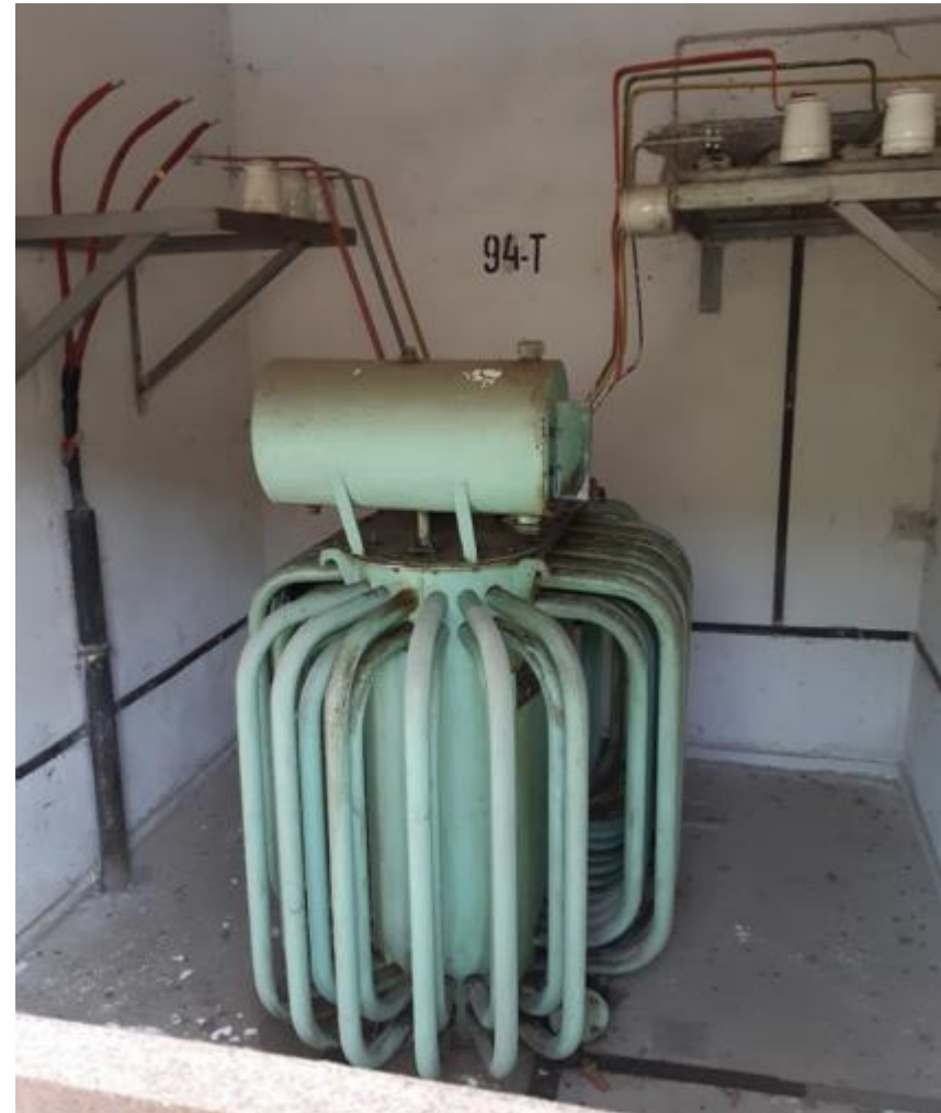
TCMA-320/6,3 tipo transformatorius.
