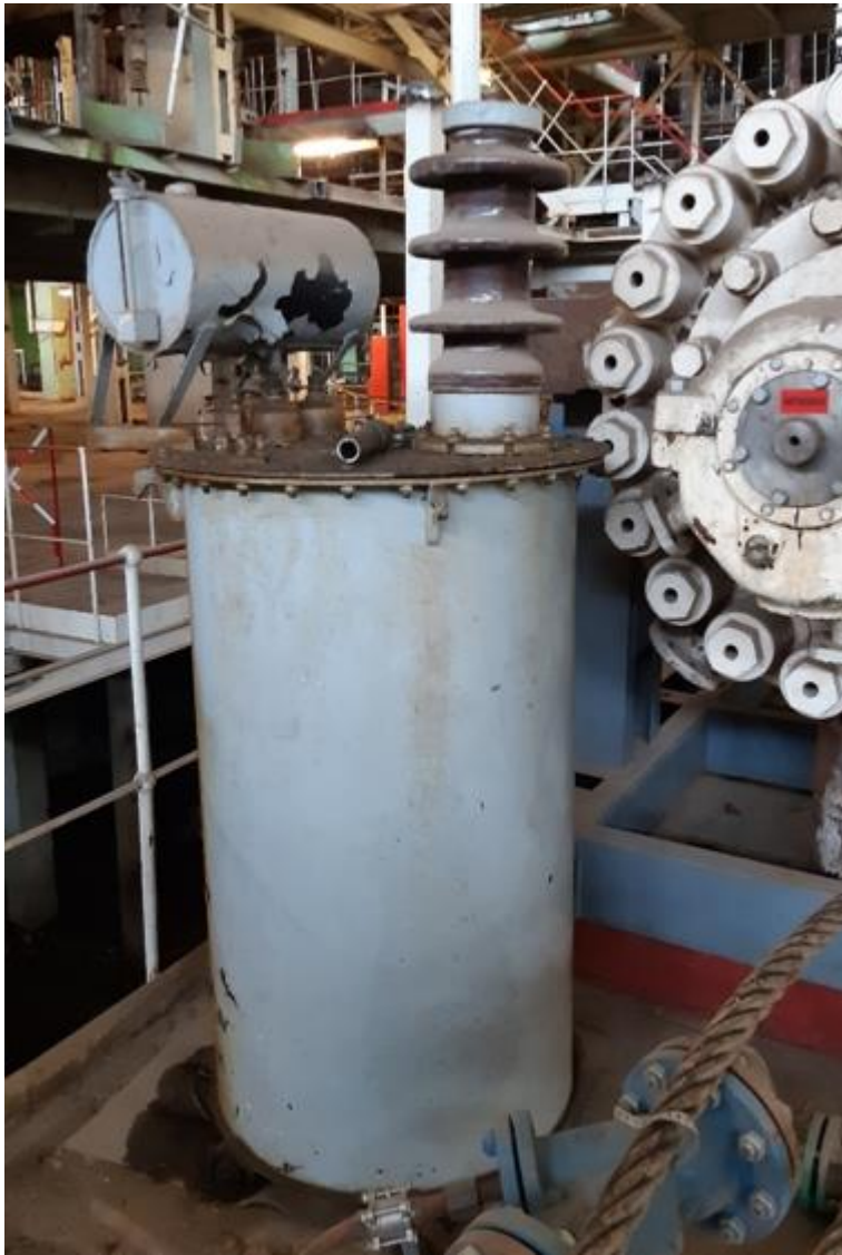
ИОМ-100/100 tipo transformatorius.
