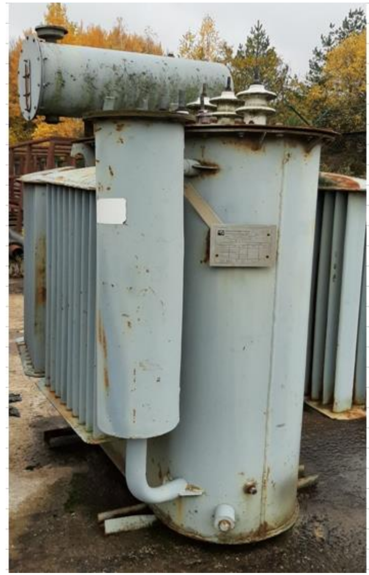
ТМ-400/10 tipo transformatorius.
